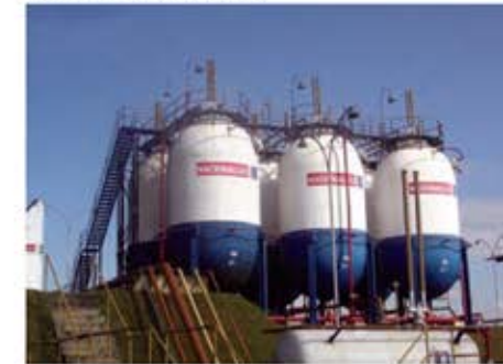
Foto 1: Tanques verticais com capacidade de armazenamento de 50 toneladas
